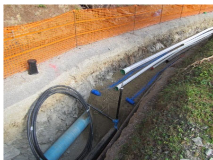
Fouille pour la pose de la conduite forcée et réfection des réseaux Chantier 2020
